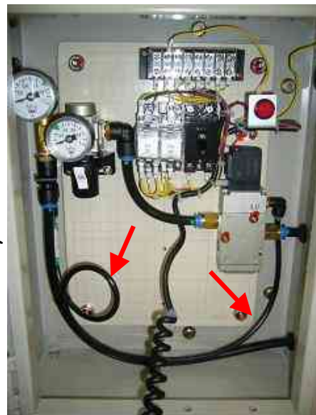
(コントロールボックス内部配管) 赤矢視は誤配管部分を示す
