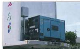
外付けの発電機
