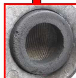
パッキンひび割れ
