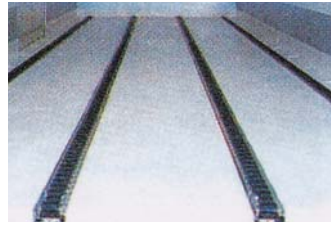
床搬送装置 (エアローラー+システムフロア)
